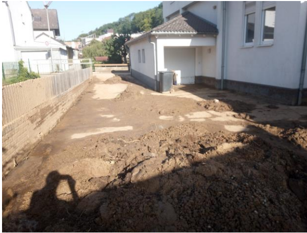
Foto: BGS Wasser
