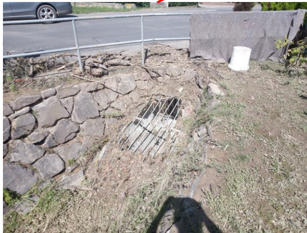
Foto: BGS Wasser
